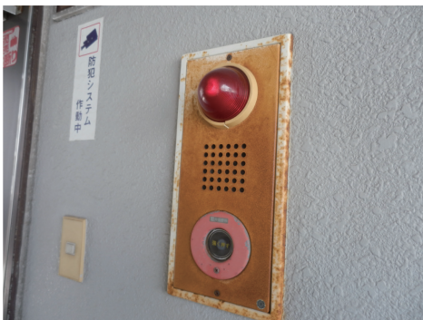
経年劣化した火災報知器
